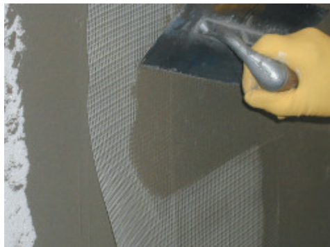
Εξομάλυνση θερμομονωτικών πλακών ενισχυμένων με υαλόπλεγμα που έχει ενσωματωθεί στη στρώση του Mapetherm AR1
